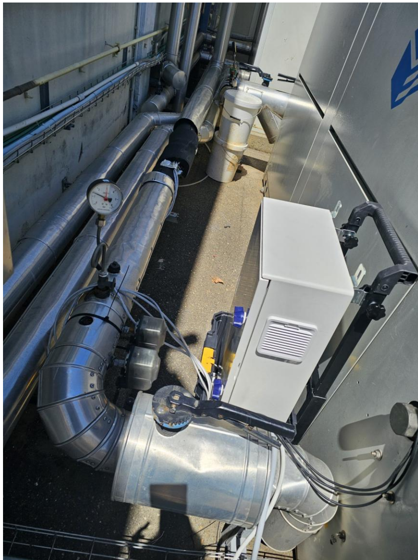
Quadro elettrico dell'unità misurata: prelievo tensioni a valle del sezionatore, bobine di corrente sui conduttori di fase e monitor ATHEMIS con EER istantaneo
