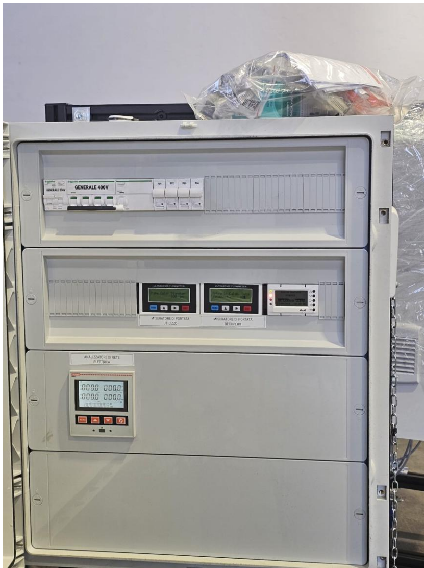
Fronte della valigetta: interruttori generali 230 V e 400 V con fusibili FU1–FU4, misuratori di energia termica «Utilizzo» e «Recupero», modulo di visualizzazione, misuratore di energia elettrica
