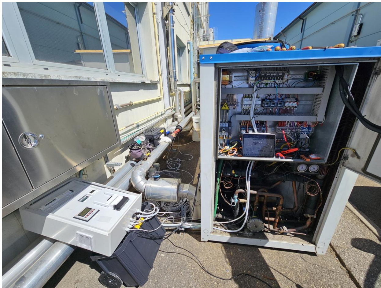
Valigetta in campo collegata a un chiller: cavi dei trasduttori e delle PT100 verso la tubazione, cavi di misura elettrica verso il quadro dell'unità
